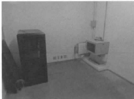
Sala dos servidores
