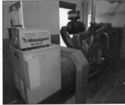
Grupo Gerador a Diesel
